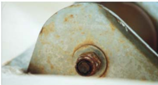
Feil materialvalg i skruer på rustfri ankervinsj over vannlinjen
